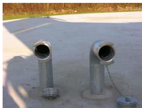
Colonnes d'aspiration (sur citerne enterrée)
