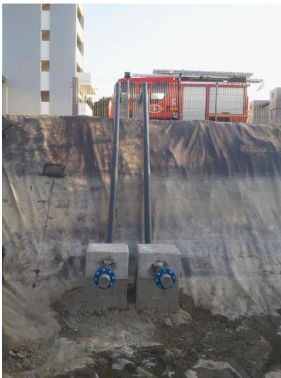
Espace dégagé autour des crépines pour éviter leur obstruction
