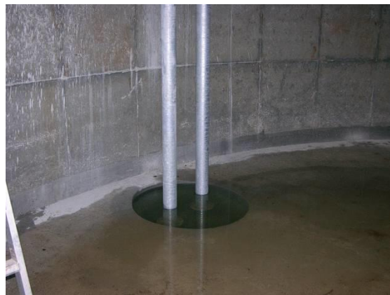
Intérieur d'une cuve enterrée avec les crépines immergées au point le plus bas
