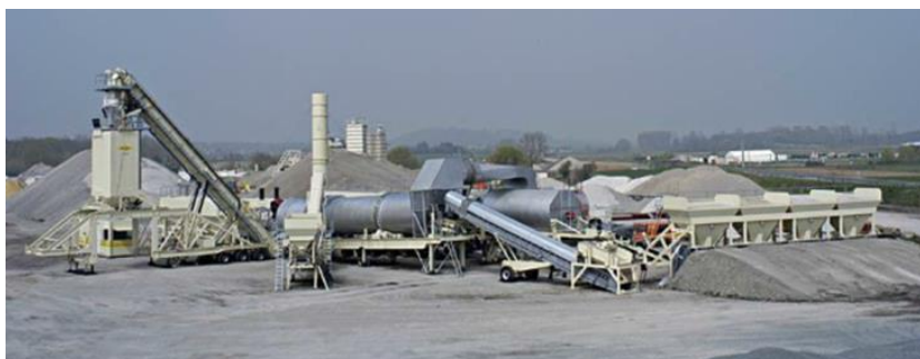
Illustration n° 2 : Photographie d'un poste de type RF500
