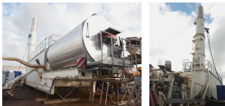
Filtre à manches et cheminée
