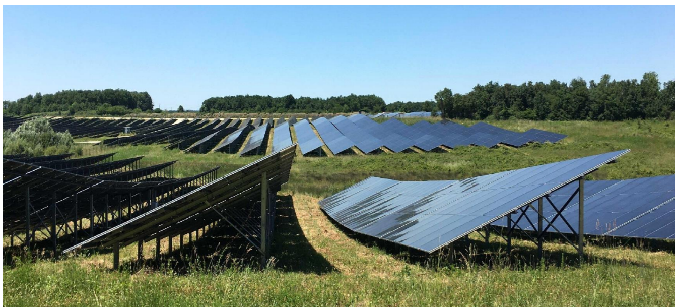
Parc solaire photovoltaïque de Nersac en Charente (Source : Urbasolar)
