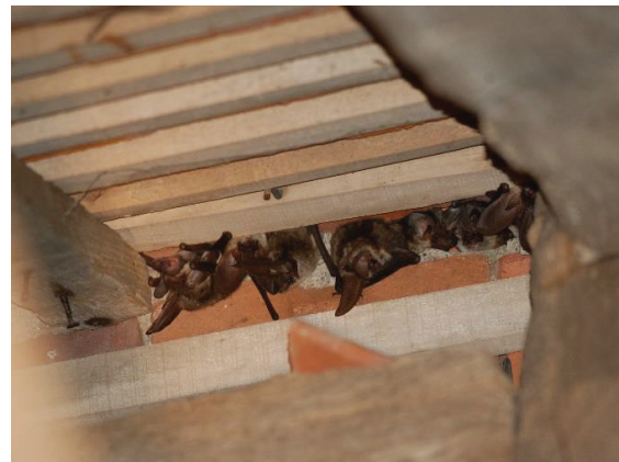
Colonie reproductrice d'Oreillards roux dans la charpente d'un grenier
