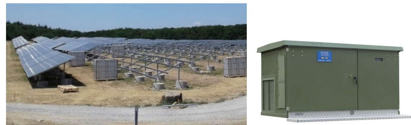
Photographie 1 – Exemple de fondation avec plot béton / pieux et poste de livraison (SMEG)
