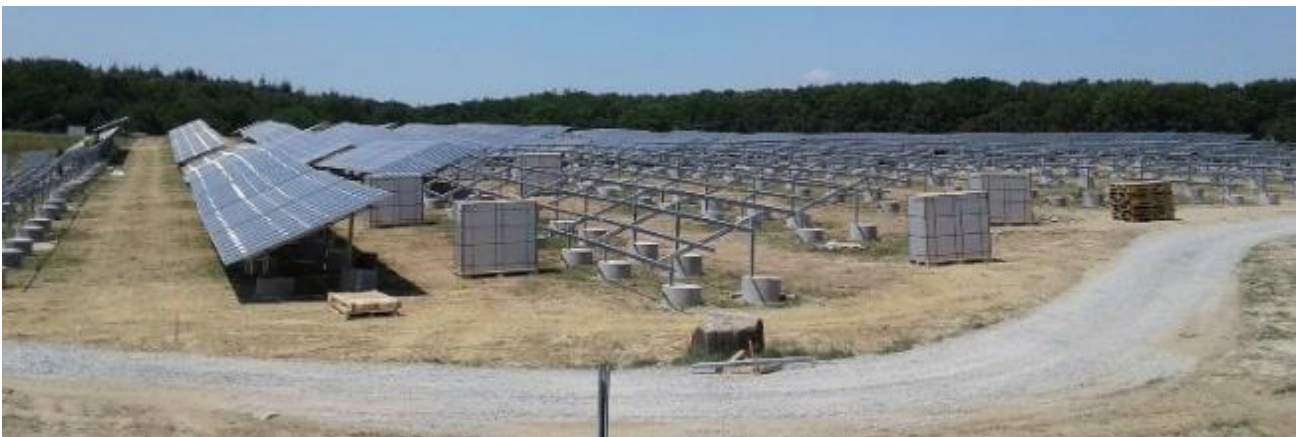
Photographie 1 – Centrale en construction : exemple de fondations hybride avec plot et pieux (SMEG)
