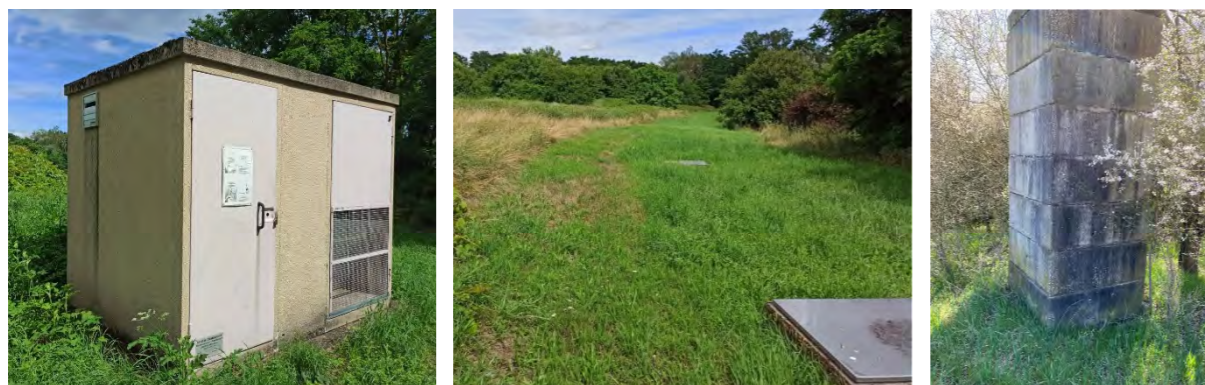
Photographie 19 – Local technique et regards des puits de lixiviats au sud de l'AER (Eco-Stratégie, 5/07/2021) et collecteur présent au nord (SMEG, 30/03/2021)
