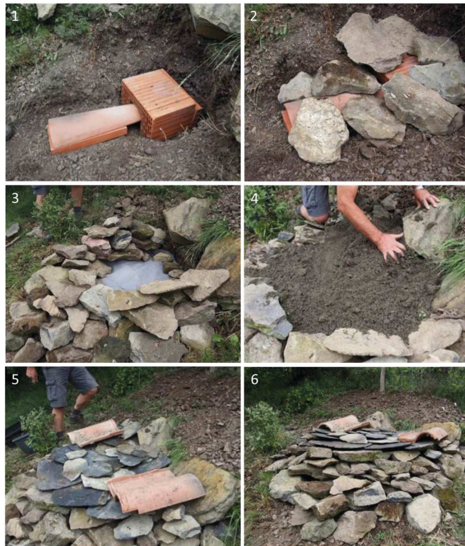
Etapes de construction d'un abri à reptiles : 1/ Creusement de la cavité et placement de l'abri profond ; 2/ l'abri est recouvert de grosses pierres ; 3/ Un géotextile est placé sur l'abri, puis un muret en pierre sèche est monté en laissant un espace au milieu ; 4/ l'espace est comblé par du sable ; 5/ le tout est surmonté d'ardoise ou de lauze, et éventuellement de tuiles ; 6/ abris terminé (Sources : Fédération Aude claire / L'Aude au Nat)
