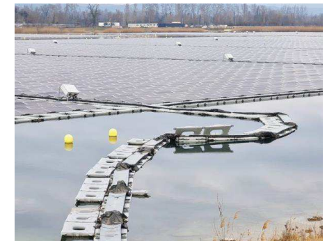
Exemple de câblage sur flotteur (source : Révolution énergétique)
