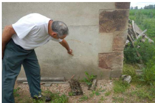
Figure 4 : Repère approximatif de crue de 2008 – Lieu dit des Violettes – Saint-Martin-des-Laix
