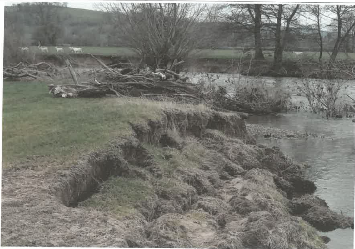
Effondrements – Dépôts de branchages et galets
