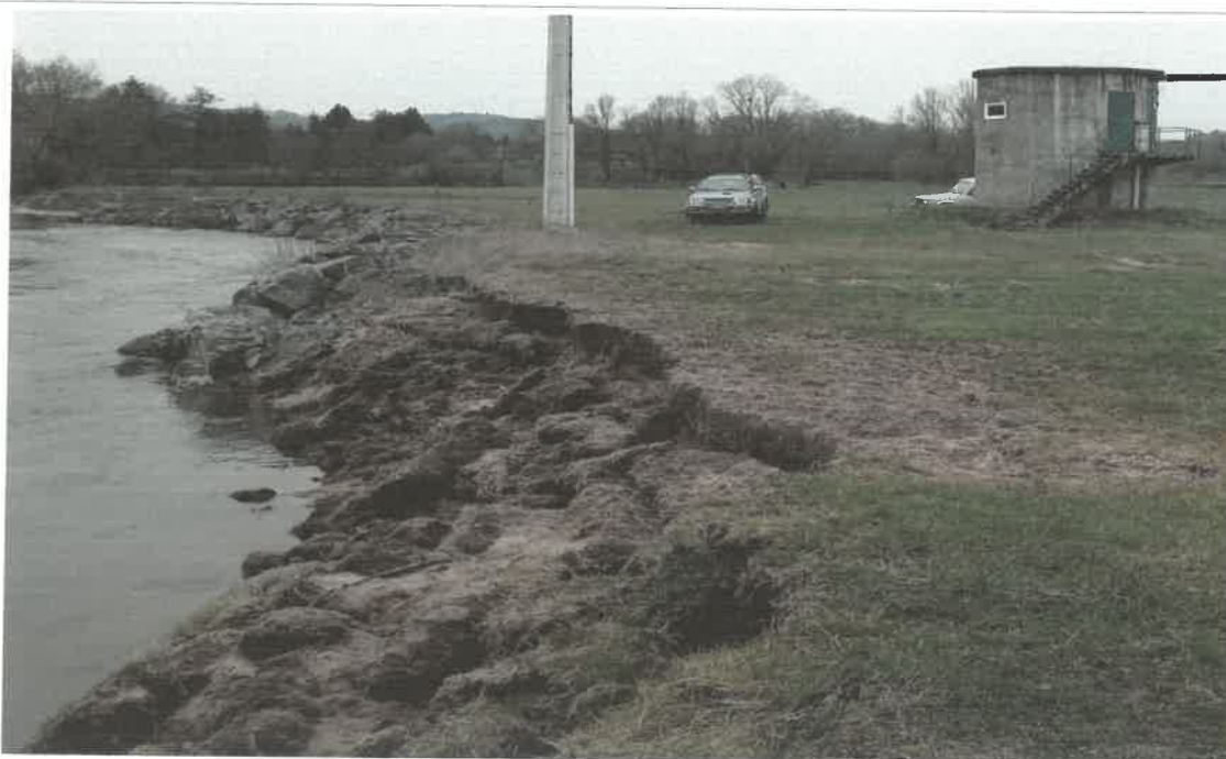
Effondrements de la berge et de la rive non protégée après inondations de février 2021
