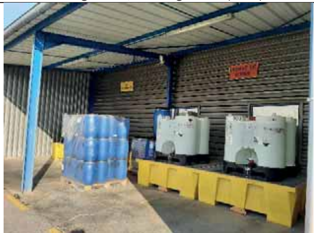
Stockage aérien d'acide chlorhydrique et lessive de soude (n°12)
