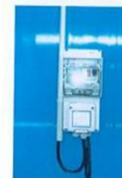
Boîtier électrique extérieur
